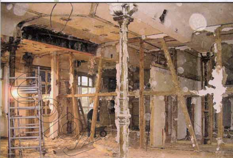
Bei der Auskernung kamen die bisher verborgenen Träger aus Eisen zum Vorschein.
